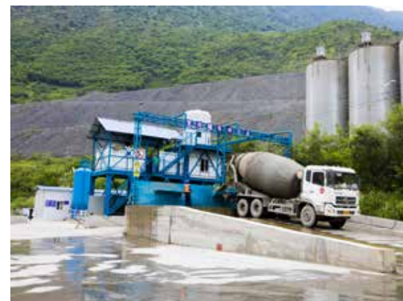
荒田罐车冲洗
