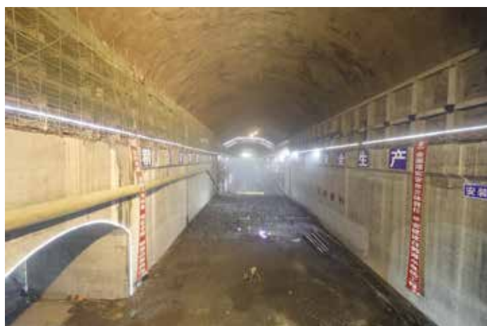
2017 年右岸地下电站主厂房
