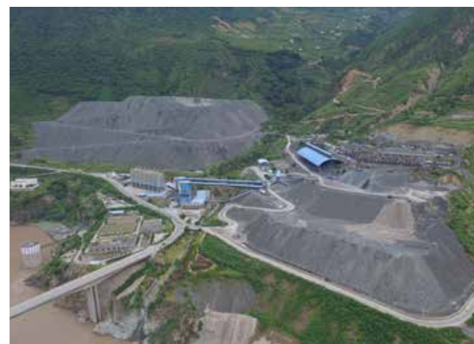
荒田砂石混凝土系统
