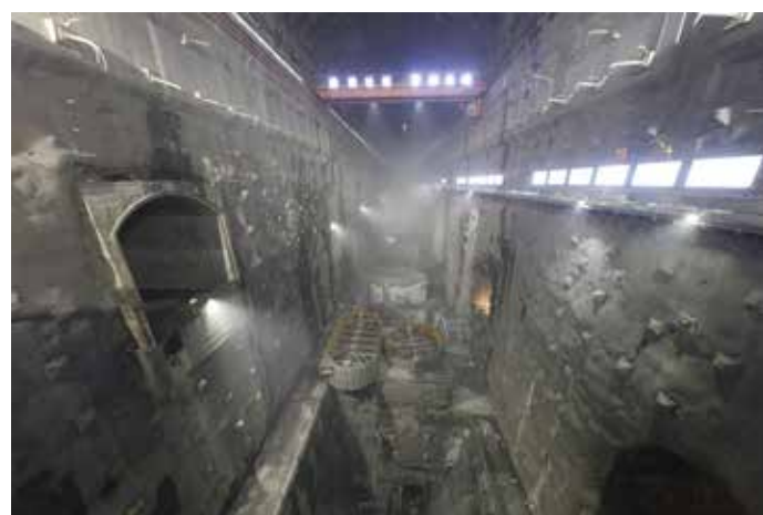
2018 年右岸地下电站主厂房
