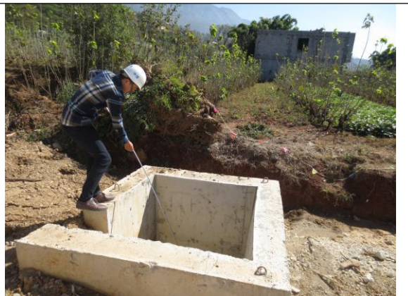
临时施工场地区沉砂池监测点
