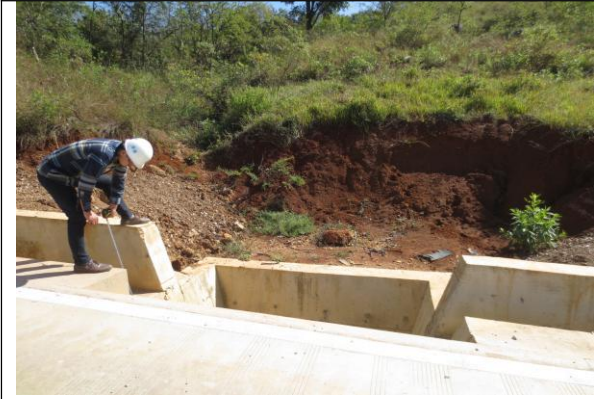
临时施工场地区沉砂池监测点
