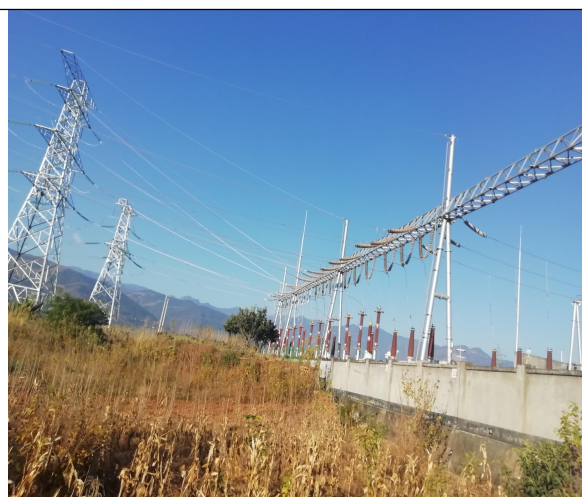
220kV 宁南变电站
