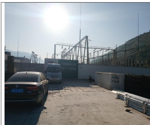
宁南 110kV 变电站
